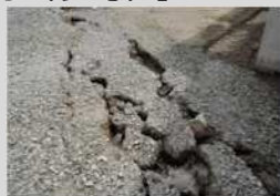
②地盤の亀裂
