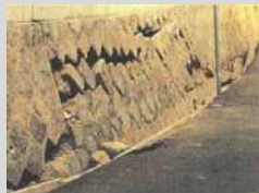
③擁壁の崩壊
