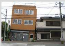
①住宅の沈下・傾斜
