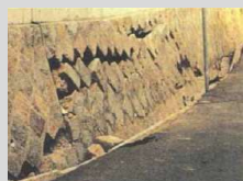
③擁壁の崩壊
