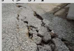
②地盤の亀裂
