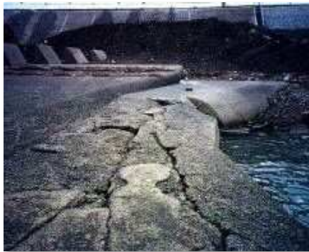
第二床固 水叩き部のひび割れ状況
