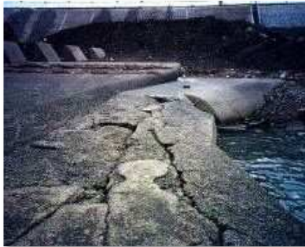
第二床固 水叩き部のひび割れ状況
