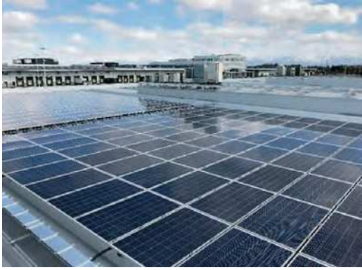
公共施設に設置された太陽光発電設備
