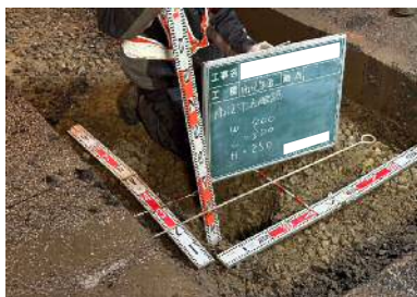
空洞確認状況
