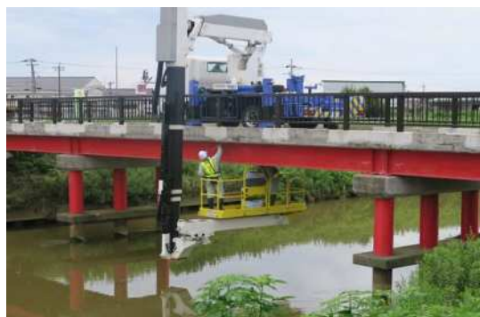
インフラ資産の長寿命化対策実施事例 (西蒲区山島橋の点検)
