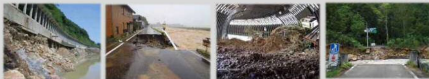
写真：左から 被災した国道459号師走スノーシェッド（新潟県阿賀町師走）、被災した国道289号（新潟県三条市荒沢）、被災した国道253号スノーシェルター（新潟県南魚沼市余川）、流出した国道352号金泉橋（新潟県魚沼市下折立）
