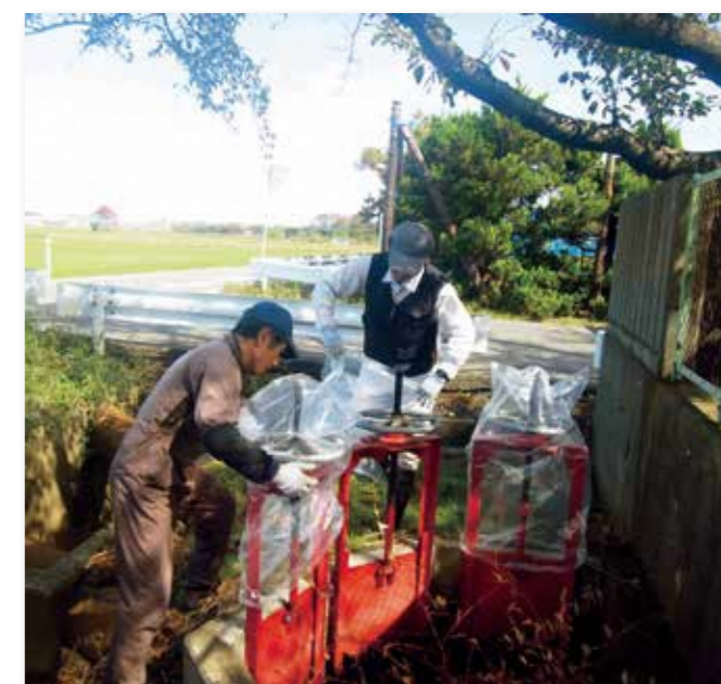
ゲートの保守管理
