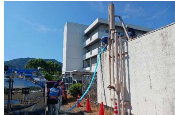
医療施設の受水槽への注水
