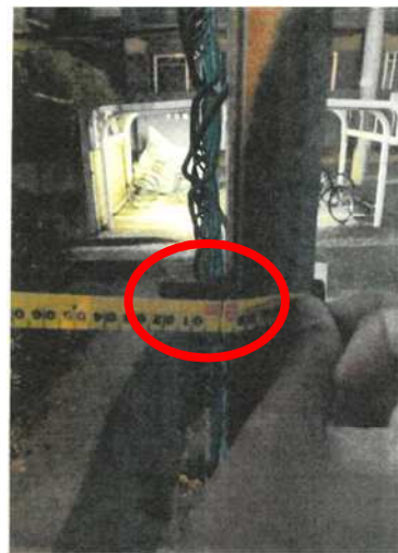
ボルト突出状況
