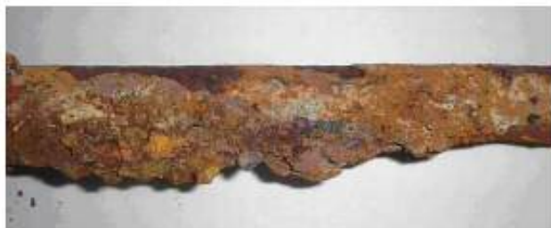
長期間の埋設で腐食した白ガス管
