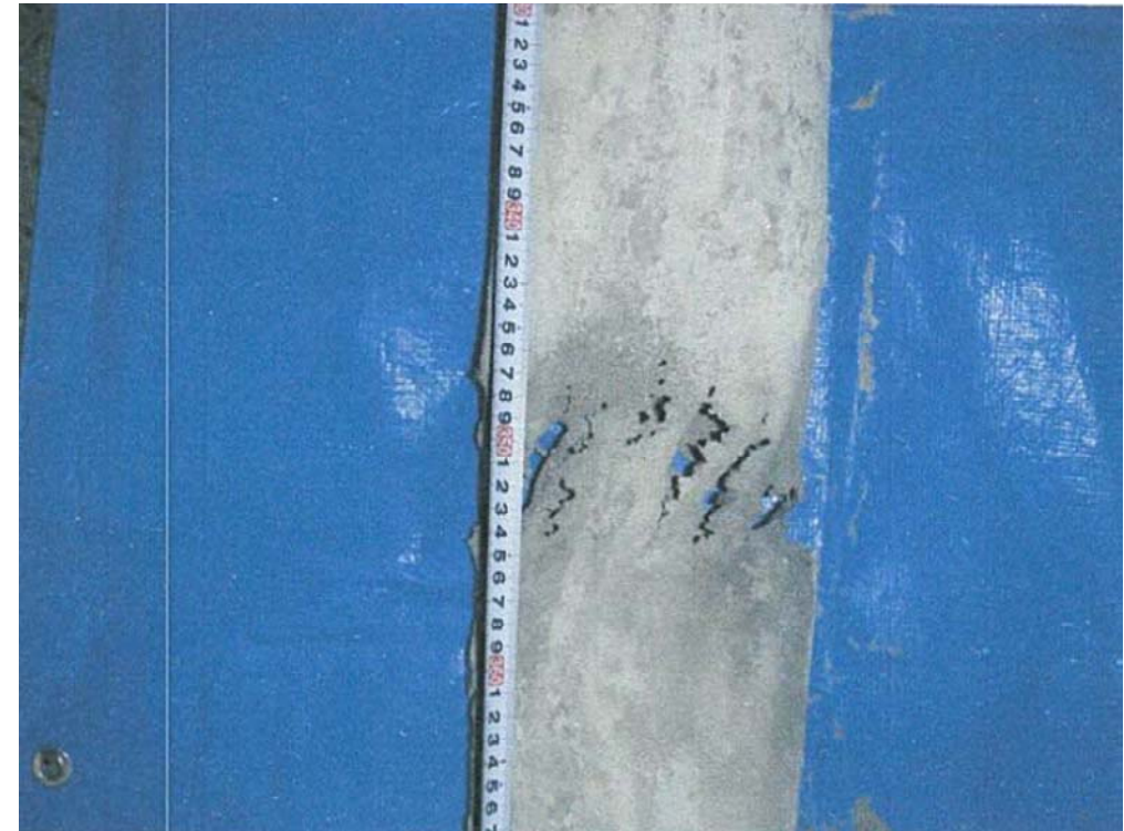
(2) バグフィルター（ろ布の破損）
