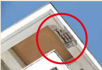
▲B棟南側玄関から見た軒下コンクリートの一部落下
