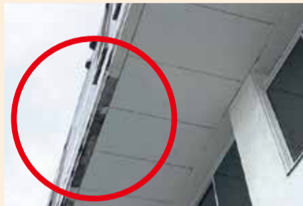
▲おもいやり駐車場から見た軒下コンクリートの一部落下
