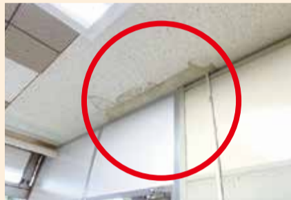
▲複数箇所からの雨漏り(室内)
