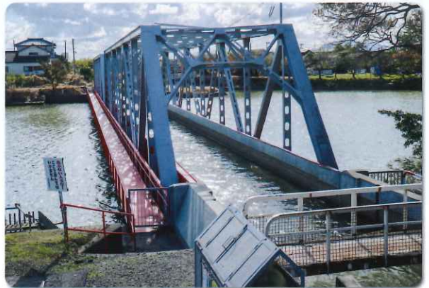
1955年に完成した新川・西川立体交差。新川が流れ、水路橋の上を西川が流れる。
