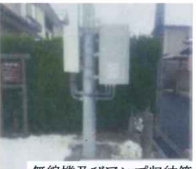
無線機及びアンテナ収納箱
