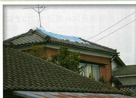
破損した屋根瓦
