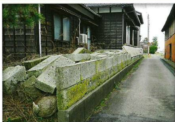
倒壊したブロック塀
