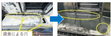
腐食による穴
