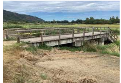
老朽化した橋梁
