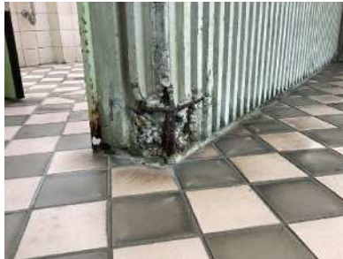
腐食したトイレの壁
