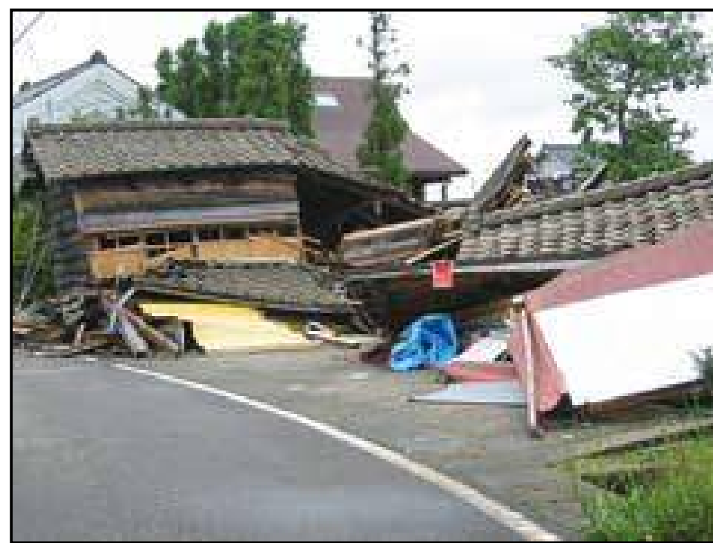
中越沖地震による家屋倒壊の様子(柏崎市)【出典:新潟県HP】
