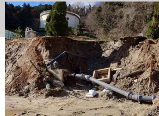
令和6年能登半島地震 浄水場被害 (石川県七尾市 岩屋浄水場)
