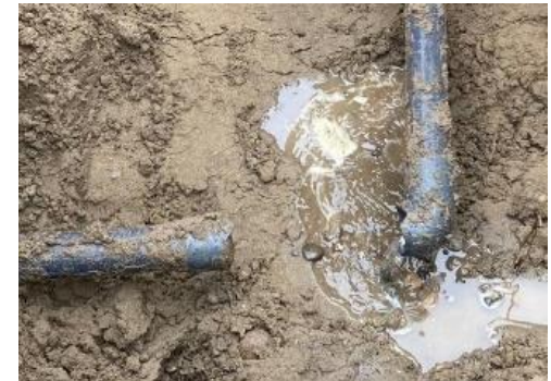
配水管の損傷状況
