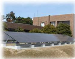
水質管理センター（19.8kw）
