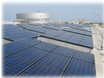
信濃川浄水場（100kw）
