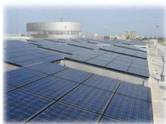
信濃川浄水場（100kw）
