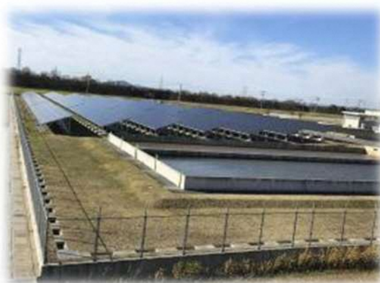
満願寺浄水場（645kw）
