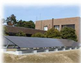
水質管理センター（19.8kw）
