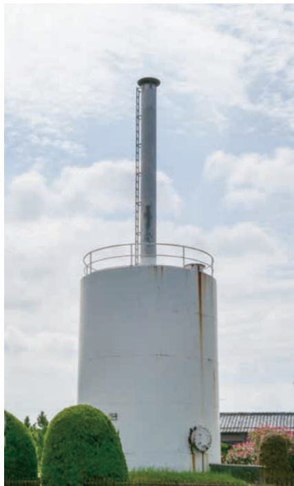
▲西区浦山にある調圧水槽①
