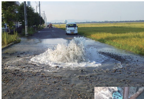
◀水道管の漏水状況
