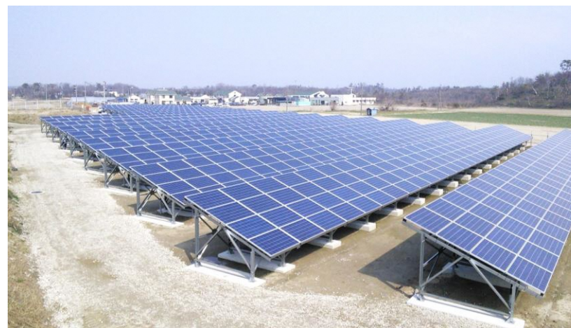
中村浜発電所(発電出力 750kW)
