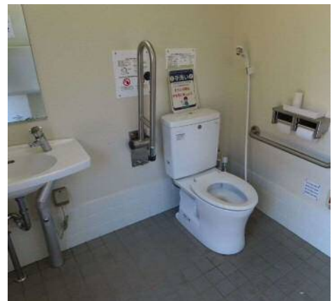
写真 2-6 多機能トイレ設備
