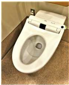
水が流せないトイレ
