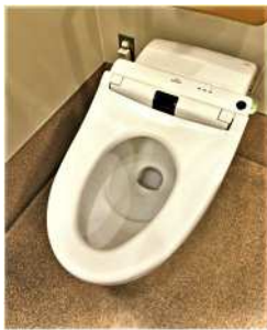
水が流せないトイレ
