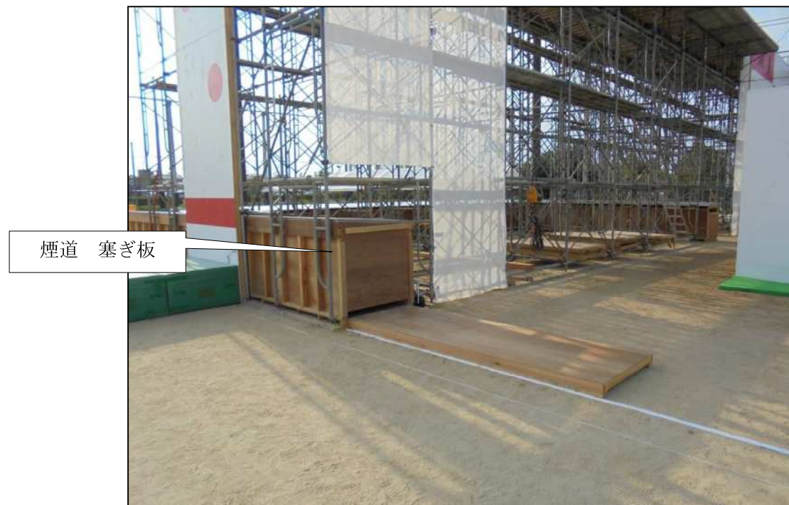
写真 18 「ほふく 救出煙道入口」
