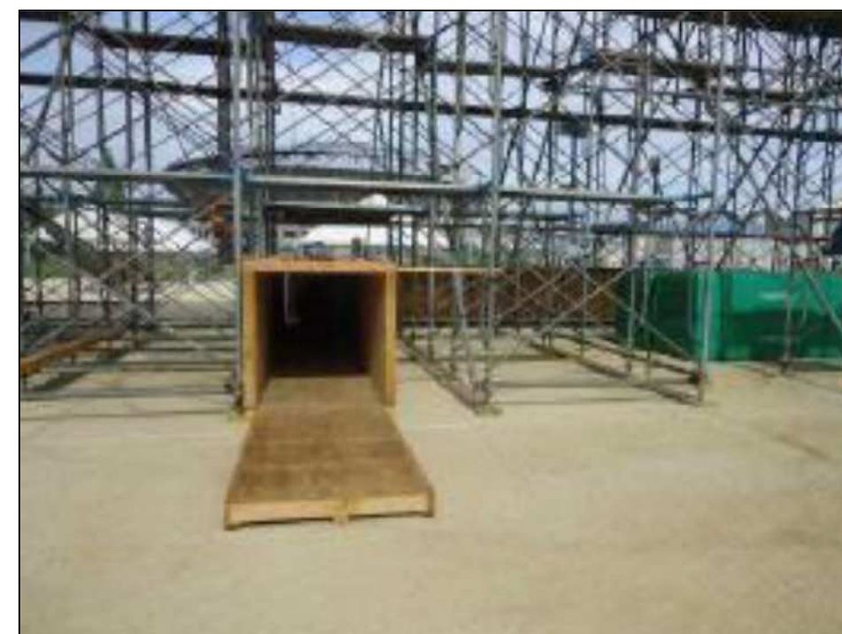
写真 21 「障害突破煙道出口」
