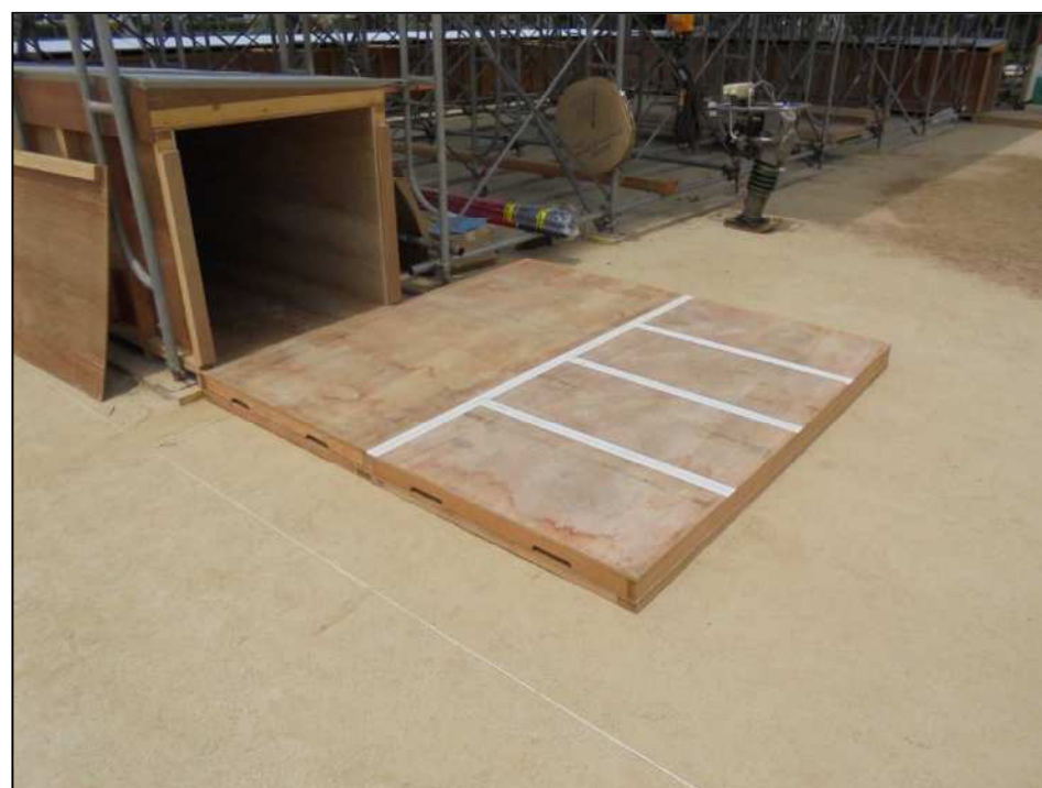
写真 20 「障害突破煙道入口」 及び 「用具配置板」
