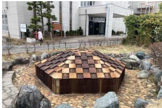
水循環システム ※現在使用停止中
