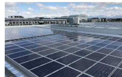
公共施設に設置された 太陽光発電設備
