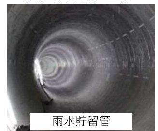
浸水対策施設の整備
