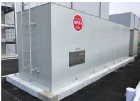
写真9 地上式防火水槽
