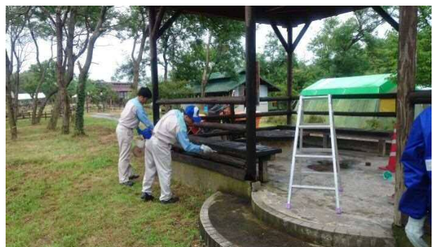
草刈り作業後の余った時間で、防腐剤の塗布も行いました。
