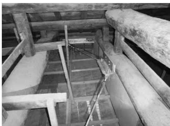
小屋裏に設置された水平構面補強用鋼製耐震ブレース
