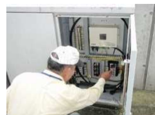
分電盤での日常管理
