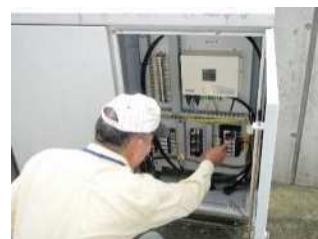
分電盤での日常管理
