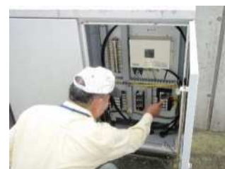
分電盤での日常管理
