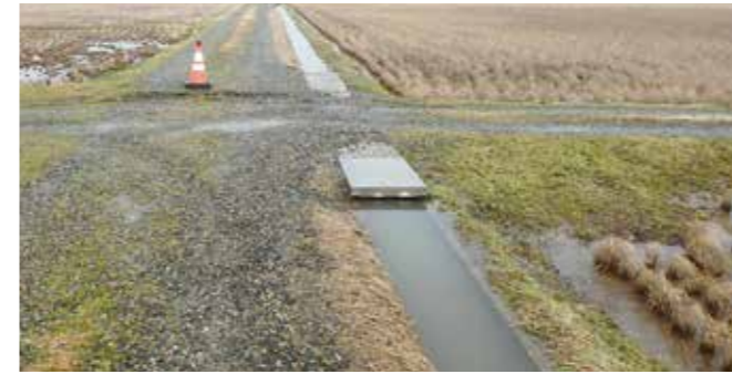
地震による農道の沈下
