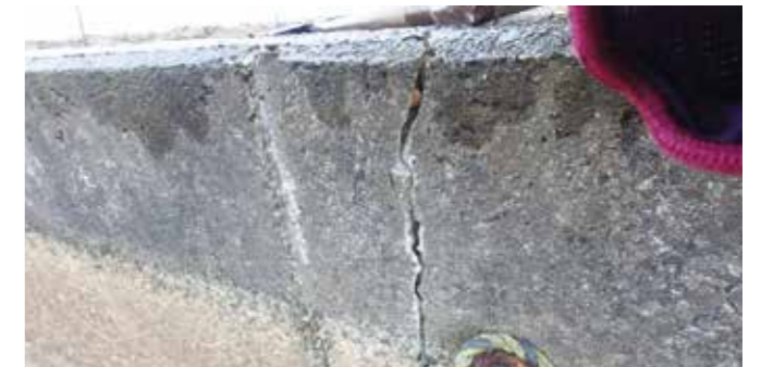
地震による水路のひび割れ
