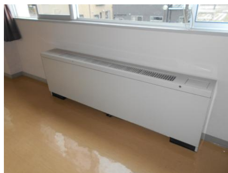
ファンコイルユニット（床置形）
