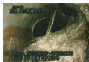
管内詰まり (木根侵入)
