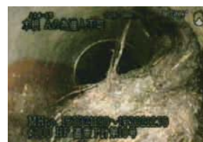
管内詰まり（木根侵入）
