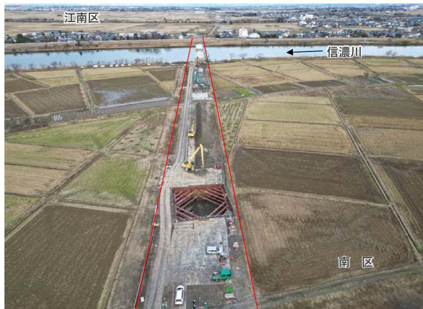
(主)新潟中央環状線(信濃川渡河工区)
