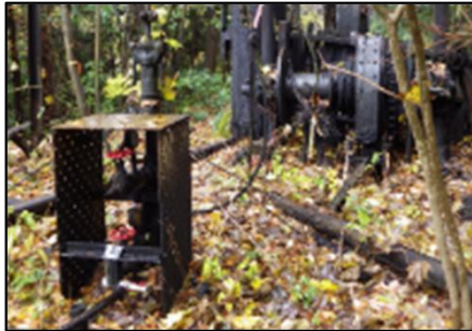
位置確定坑井 [坑口圧力 管理中]
