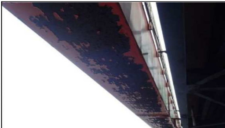
歩道下の腐食状況
