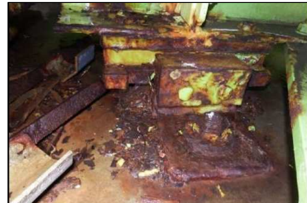
橋の接合部の腐食状況
