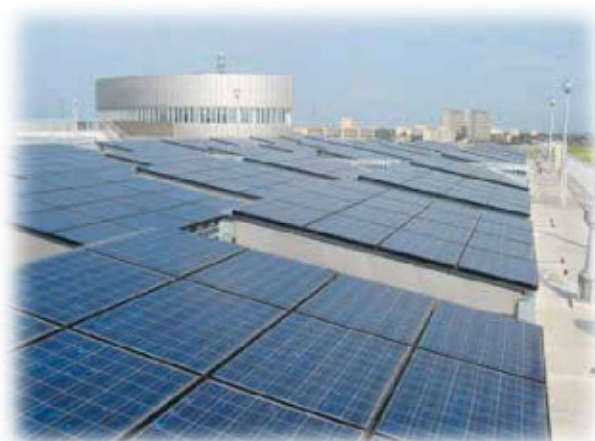
太陽光発電設備（信濃川浄水場）
