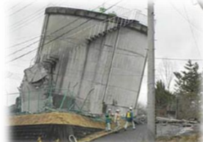
東日本大震災における配水塔の倒壊 (岩手県)
