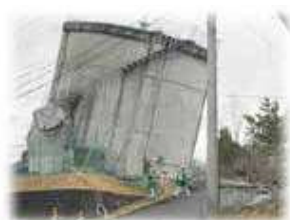
東日本大震災の余震により倒壊した配水塔 (岩手県) 出典元：厚生労働省
