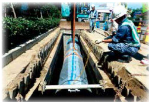
基幹管路（写真：NS形ダクタイル鋳鉄管）
