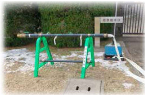
応急給水設備
