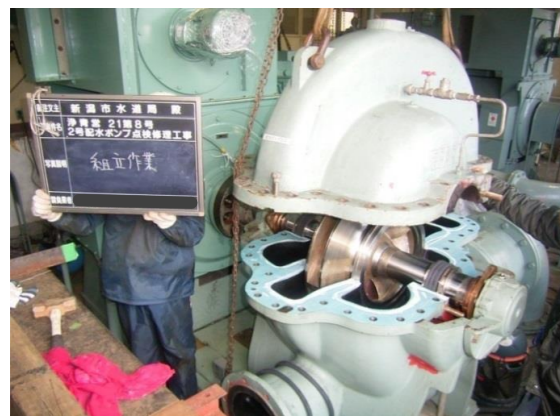
配水ポンプ設備分解整備写真（ポンプ）
