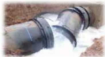
東日本大震災による送水管の抜け出し (φ2400mm) (宮城県) 出典元：厚生労働省
