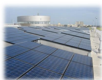
太陽光発電設備（信濃川浄水場）
