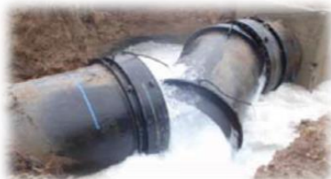
東日本大震災における送水管の抜け出し (宮城県)
