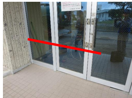
平浄水場玄関（赤線部まで冠水）
