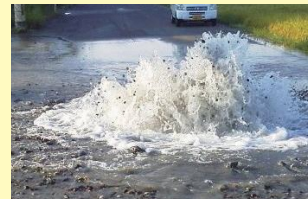
水道管の漏水
