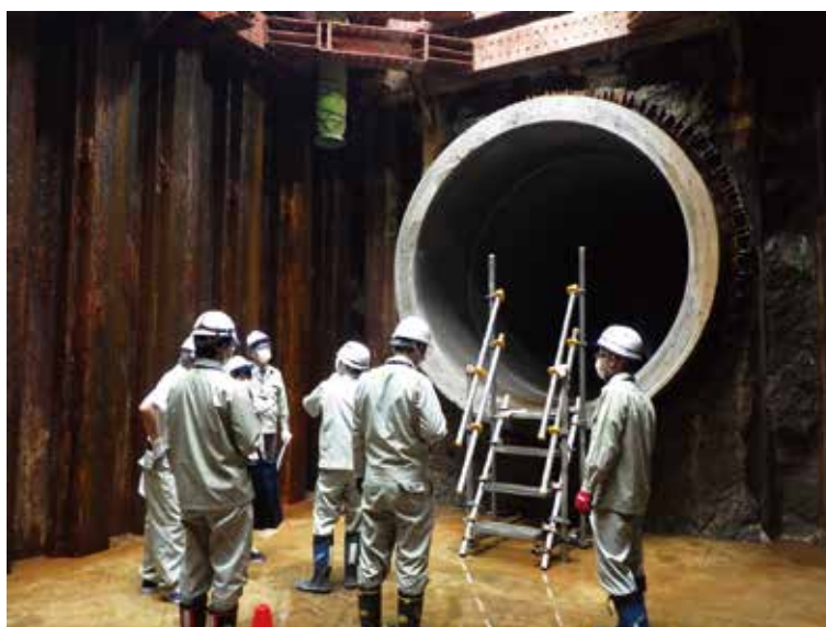
雨水貯留施設の整備
